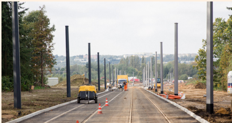
Auf der fertig asphaltierten Bahn-/Bustrasse wird mit den Straßenbahnen ab Ende 2017 auch die neue Linie 82, bekannt als "Ringbuslinie", verkehren.
